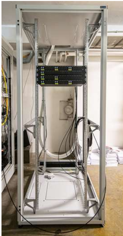
Zakončení optické kabeláže v centrálním datovém rozvaděči
